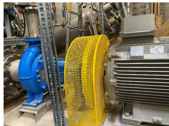
75kW Asynchron Motor mit Andritz Radialkreislumpumpe
